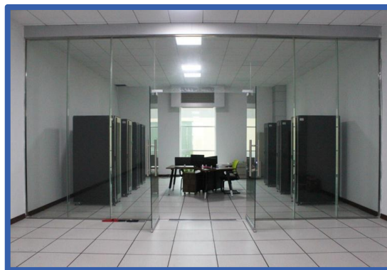
C 中心机房
