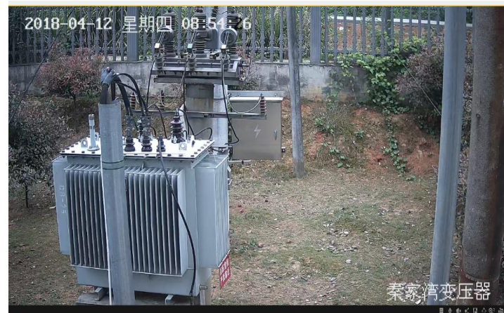
变电站监控视频
