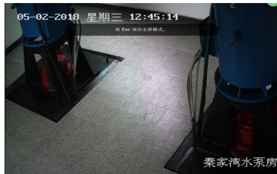
水泵房监控视频
