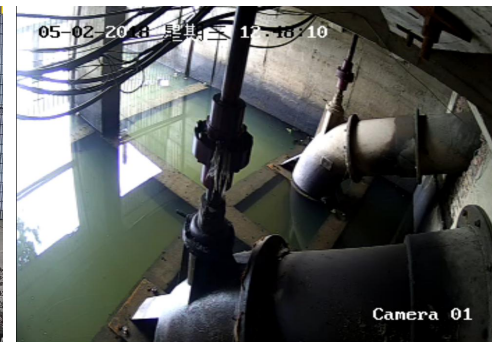
水泵下轴监控视频
